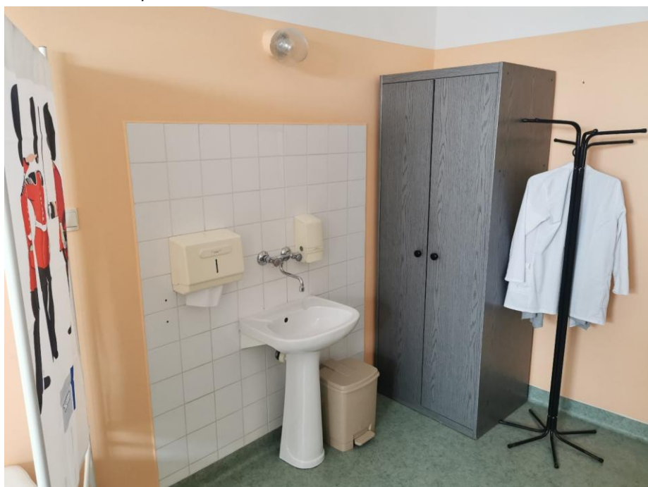
Gabinet lekarski przed remontem.
