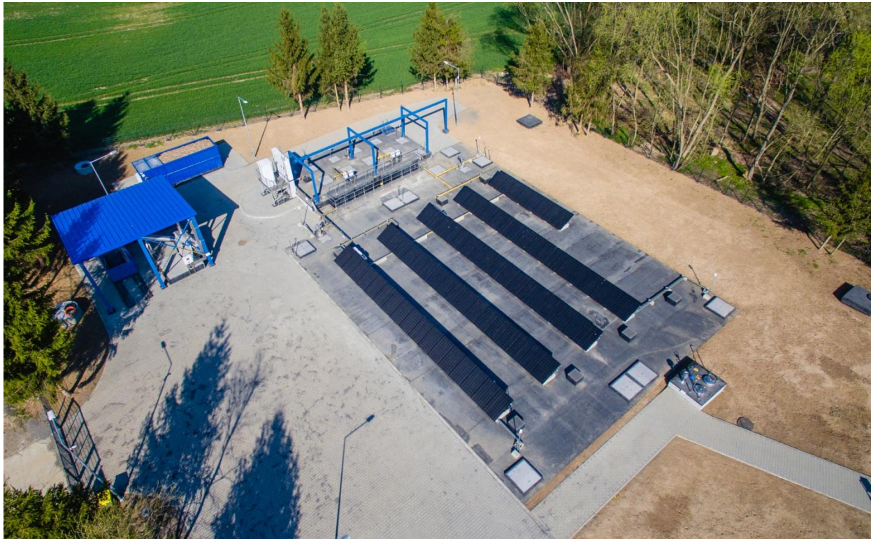
Zmodernizowana przepompownia Z-3 przy ul. Legnickiej
